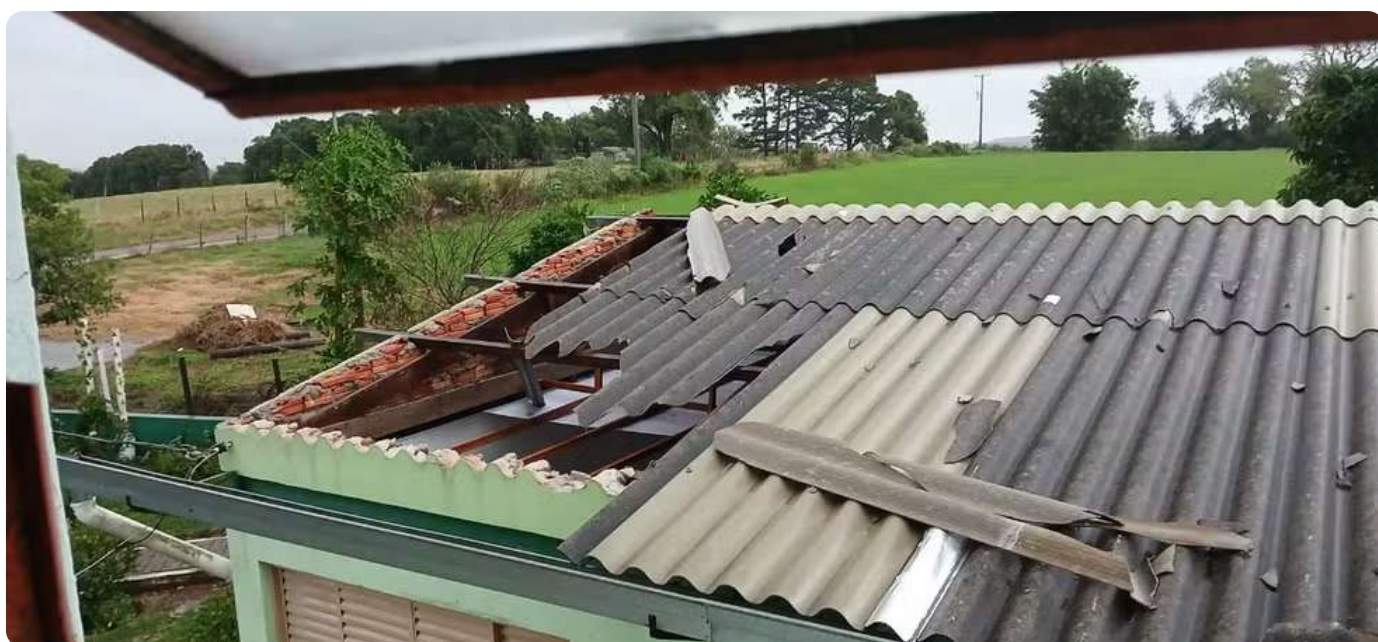
Alegrete teve casas e prédios públicos destelhados — Foto: Defesa Civil de Alegrete
